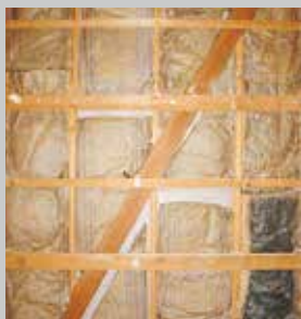
水を吸って、収縮した断熱材（築15年）
