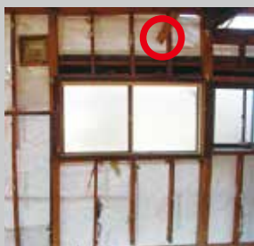
筋交いが切断されている
