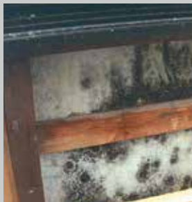
カビがはえた断熱材（築7年）
