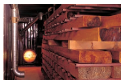
乾燥室内部を130℃まで上げ、木材の水分を蒸発させます。
